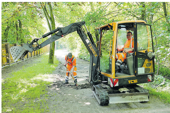
Wilfried Kruse und Ulrich Manthey-Wessels vom Wardenburger Baubetriebshof sind hier beim Ausbessern eines Verbindungsweges aktiv.
